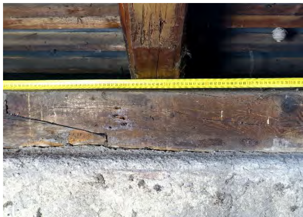
Abbildung 4-99: Hausbockbefall an der Fußpfette [105]
