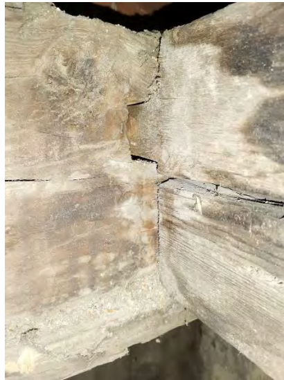
Abbildung 4-45: Foto der klaffenden Verbindung des Wechselbalkens mit dem Bundtram [102]
