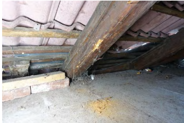
Abbildung 4-97: Sparren mit geringfügigem Fäulnissschaden [105]
