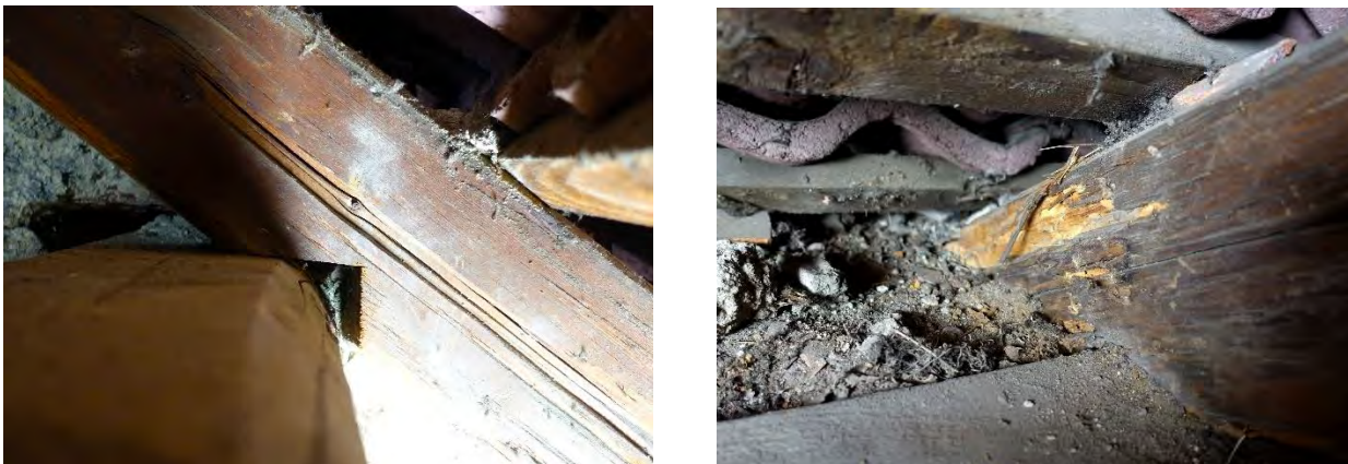
Abbildung 4-96: links: lageverschobener Sparren; rechts: Schaden am Sparren im Traufenbereich [105]
