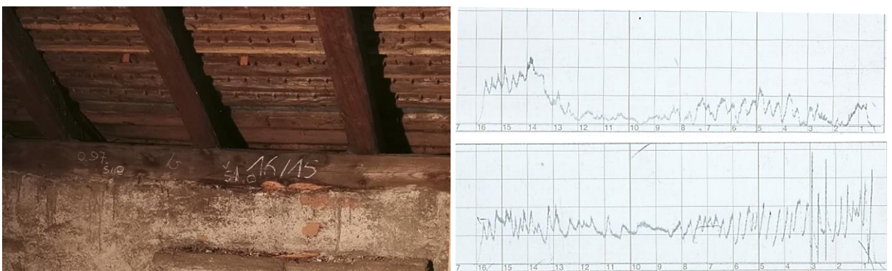
Abbildung 4-56: Bohrwiderstandsmessung an einer durch Feuchte beschädigten Stelle (links: Stellenaufnahme; rechts oben: Š1 beschädigte Stelle; rechts unten Š1.1)
