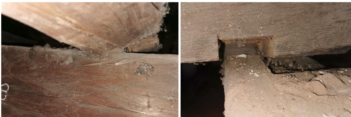
Abbildung 4-52: Verdrehung des Kehlbalkens
